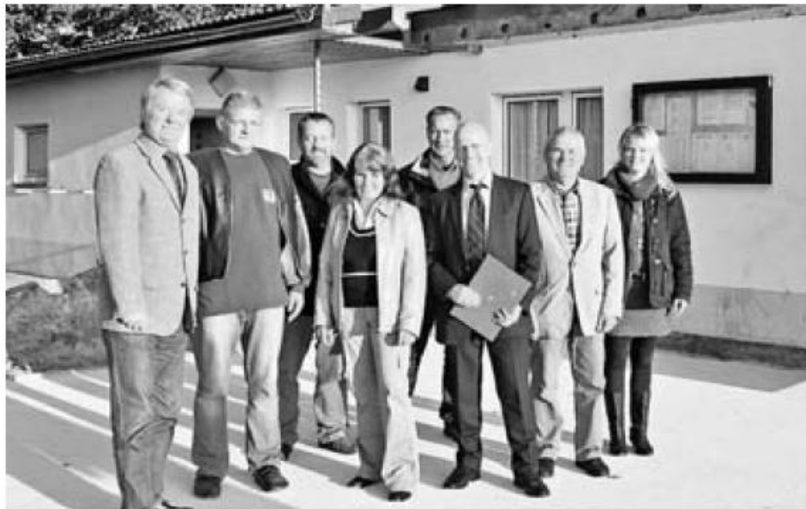
Sportheim-Anbau: Bürgermeister und Vertreter von MSV Meinkot und DM-Bau stehen schon auf der Bodenplatte des neuen Multifunktionsraums. Foto: Imke Schulze
